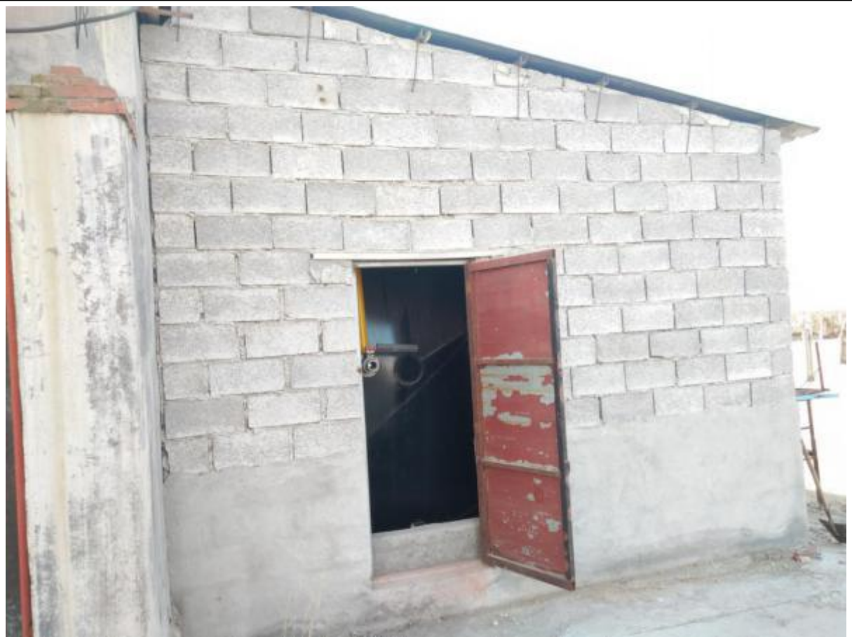
图 3-4 醇基燃料储罐区
